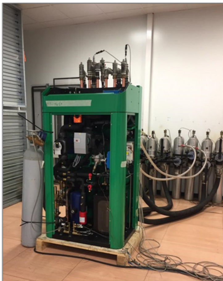
Αντλία θερμότητας κατά τις εργαστηριακές δοκιμές
